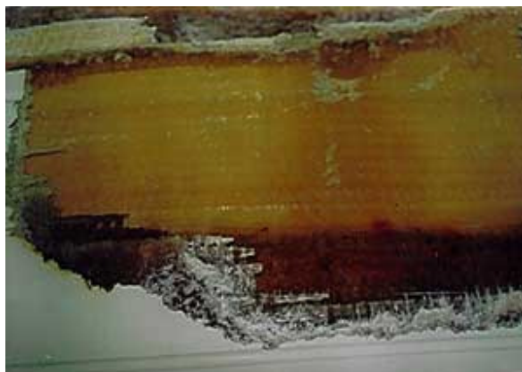
Рис. 2. Разрушения корпуса судна Grand Banks 46. Участок расслоения между двумя слоями стеклопластика, изготовленного из рубленного ровинга, где адгезия отсутствует.
