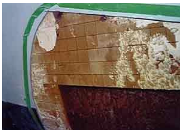
Рис. 4. Некачественная приклейка вспененного заполнителя на стеклопластиковом корпусе 60-футовой яхты.
